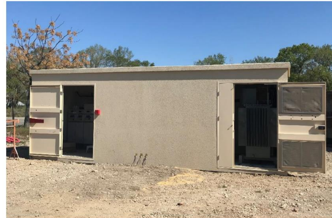
Figure 5 : Photographie d'un poste de livraison/transformation
